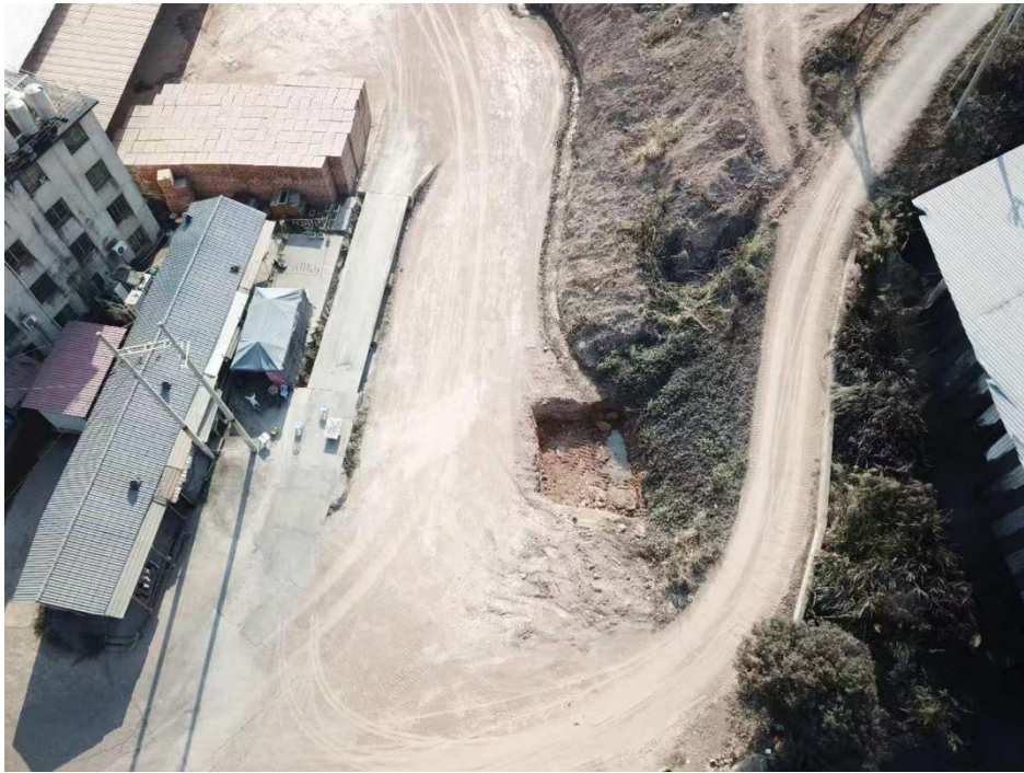
西側截排水沟及沉砂池
