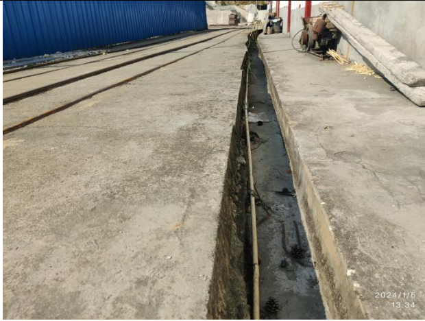
生活区排水沟
